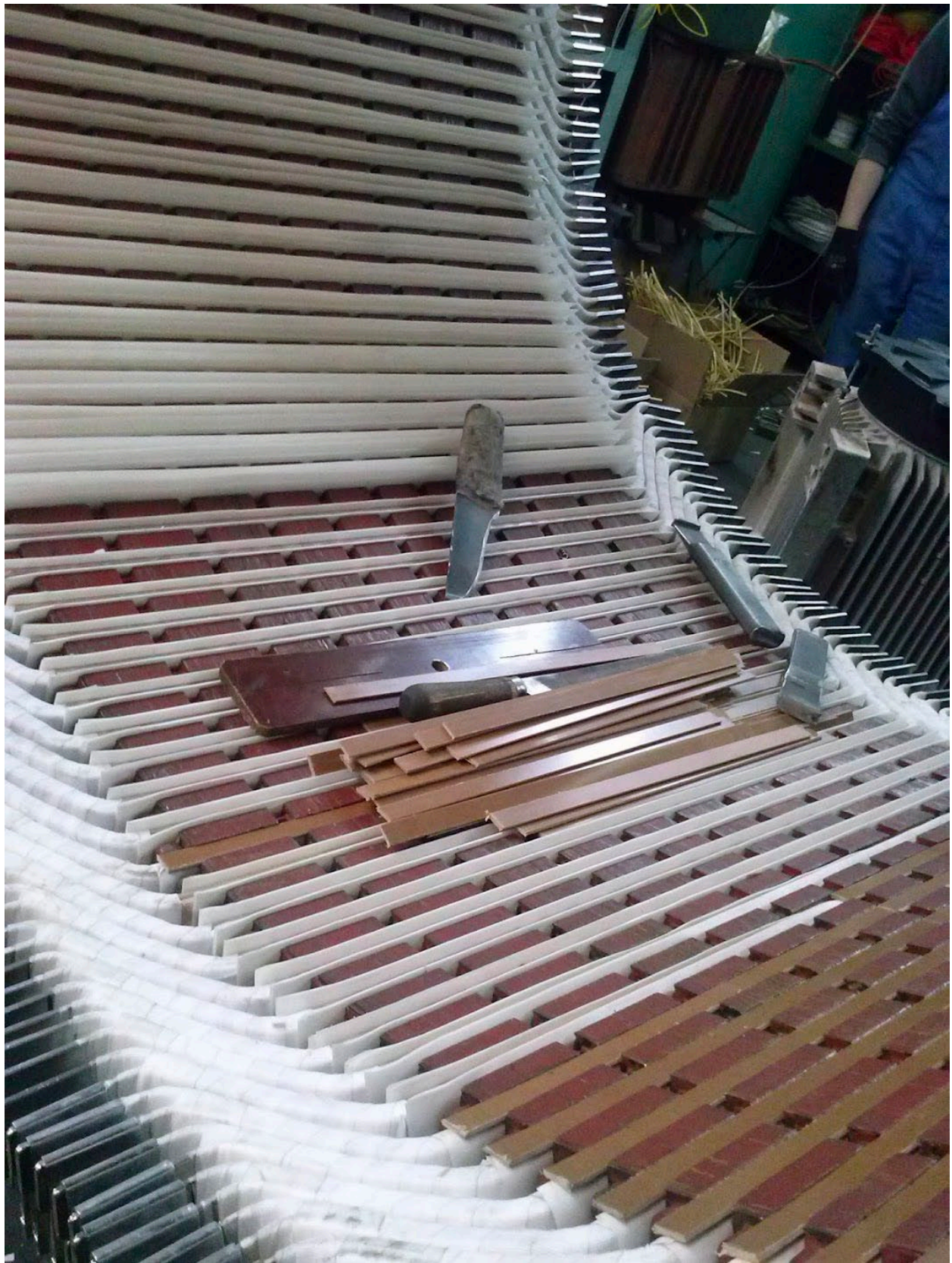
Generatorn får nya kopparlindningar.
